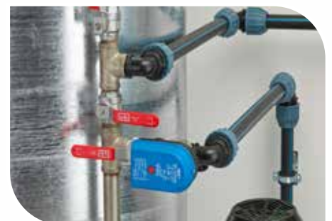
Rückspülleitung mit Motorkugelhahn
