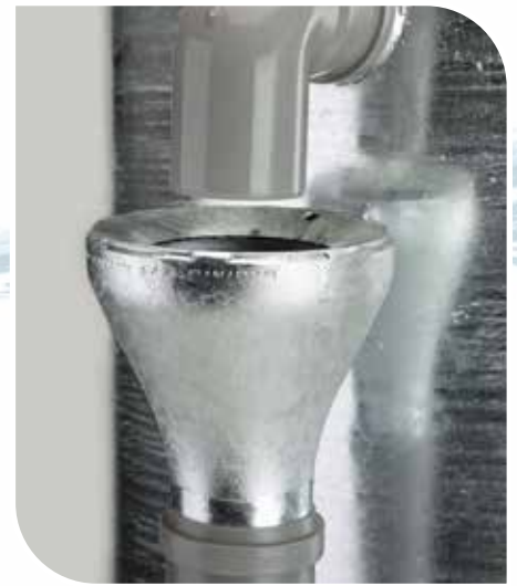
Überlauftrichter mit freiem Auslauf
